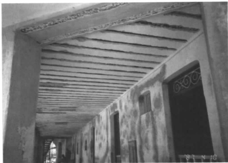
Figura l. Forro de abobadilhas com teto e paredes avariadas. (2003)
