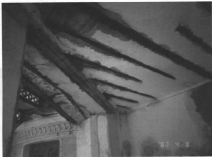
Figura a. Recuperação de 2003. Avarias na estrutura em abobadilha com oxidação do ferro.
