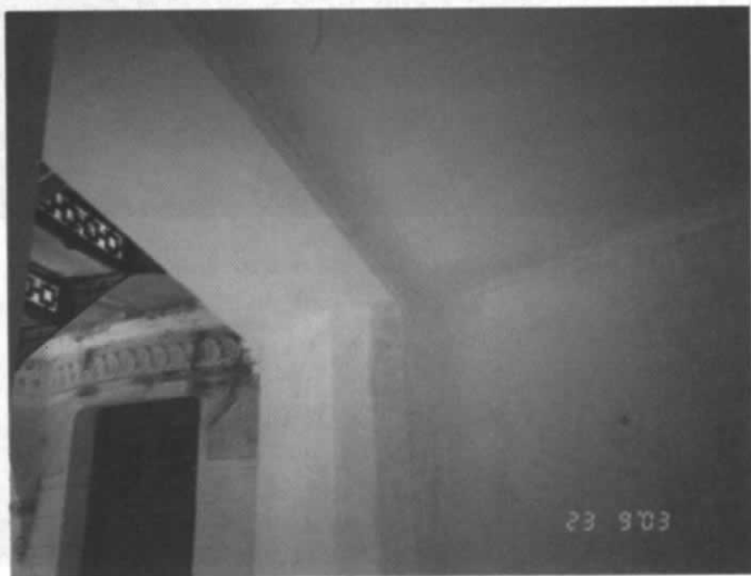
Figura b. Recuperação das avarias mostradas na Figura a. (2003)
